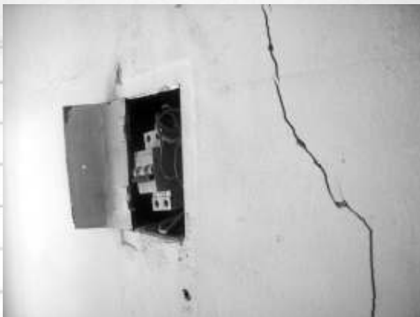
Rajaduras en la pared interna junto a la caja de llaves de electricidad
