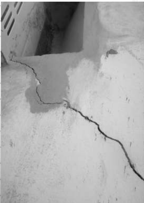
Rajaduras en la pared externa junto al aire acondicionado
