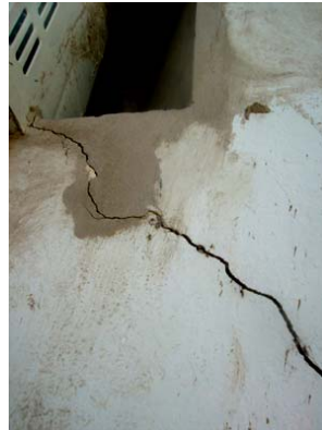
Rajaduras de 3 cm de ancho
