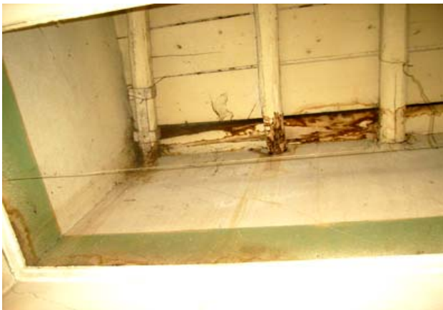
Tirantes podridos del techo
